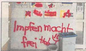
Straftat: die Schulfassade wurde beschmiert. Foto: Frei
